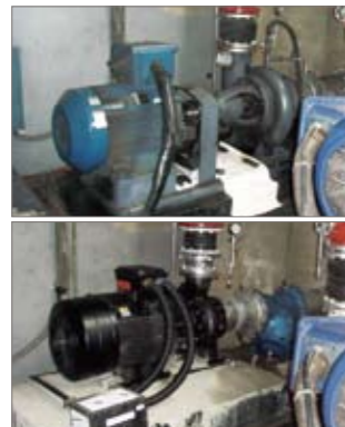
고가수조 펌프 개선 전/후
