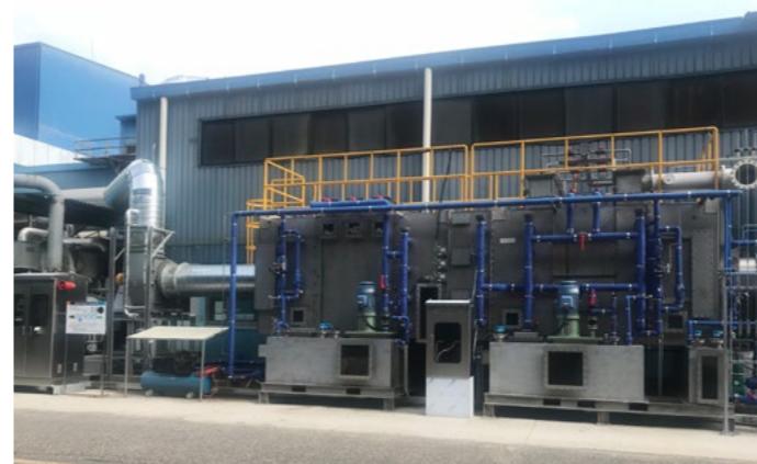
Wet EP System Test 설비
