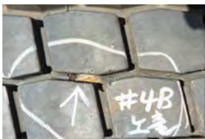
<Fissure des rainures de type 1>
